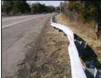
ج: خم شدن و عقب رفتن حفاظ بیشتر از حد مجاز یا تخریب بیش از ۳ پایه متوالی
